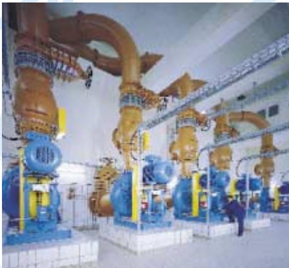
RITZ-Pumpen werden termingerecht geliefert und betriebsfertig installiert.
