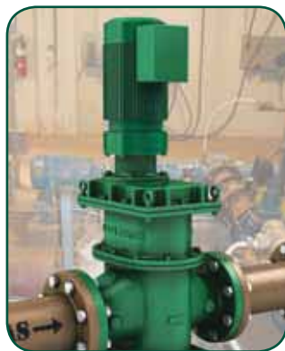
Sludge Monster in der Schlammleitung
